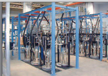
Большие экструзионные поршневые насосы с коэффициентом 13:1 установлены для формуляции оффсетных чернил.
