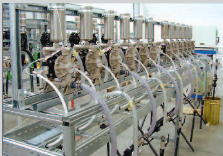
1/2" насосы, установленные для смешивания чернил (формуляция).
