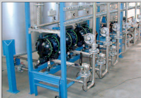
1 1/2" алюминиевые диафрагменные насосы, установленные для питания химического реактора.
