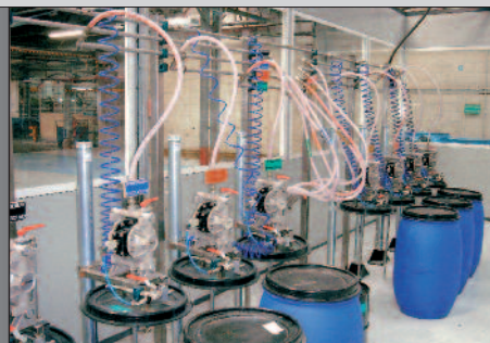
1/2" диафрагменные насосы, установленные для красок.
